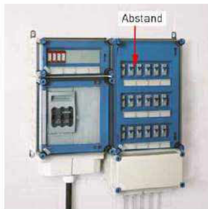
Bild 16: Verteiler für PV-Anlage (Quelle Hensel)
