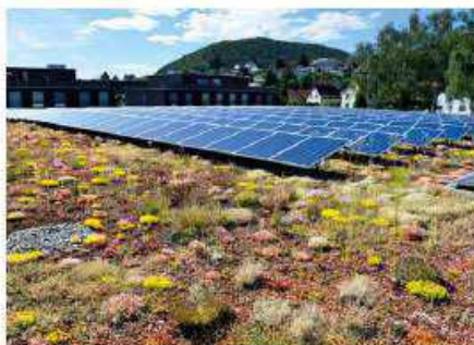
Abbildung 4: Extensive Dachbegrünung in Kombination mit PV-Anlage.
