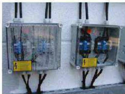
Bild 17: Kondenswasserbildung im Generatoranschlusskasten (Quelle Markus Scholand)
