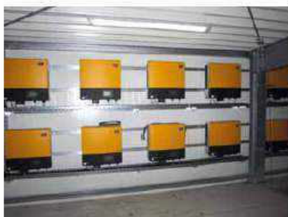
Bild 9: Wechselrichter auf nichtbrennbaren Untergrund
