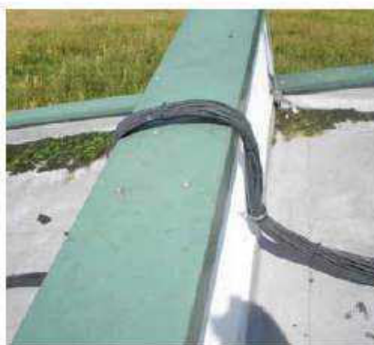
Bild 3: nicht erlaubte Verlegung von Leitungen über eine Brandwand (Quelle VGH)
