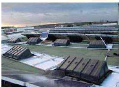
Bild 8: Sturmschaden durch Nichtbeachtung der Systemstatik (Quelle Mannheimer)
