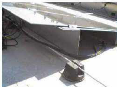
Bild 19: Abstand zwischen DC-Leitungen und Blitzschutzanlage nicht eingehalten (Trennungsabstand) (Quelle VGH)
