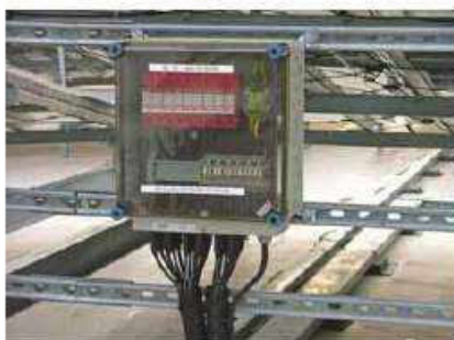
Bild 20: Generatoranschlusskasten mit Überspannungsschutzgeräten (Quelle Hensel)
