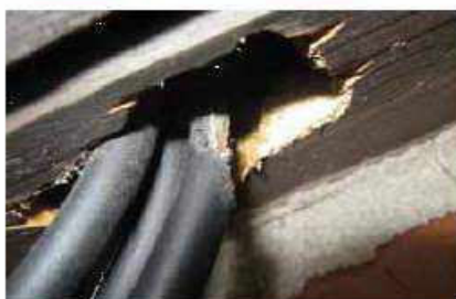
Bild 12 und 13: Beschädigungen von Leitungen (Quelle Markus Scholand)
